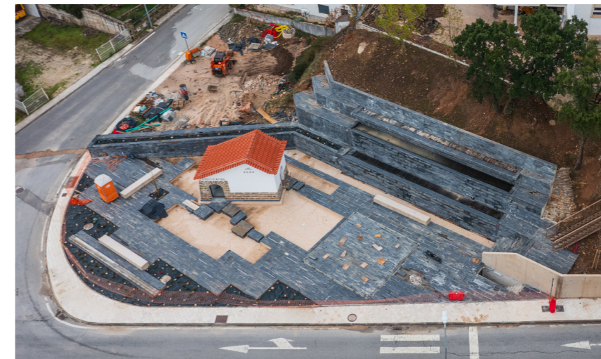
CONTINUAÇÃO DOS TRABALHOS DE ARRANJO URBANÍSTICO ENTRADA OESTE DA VILA DE PAMPILHOSA DA SERRA
