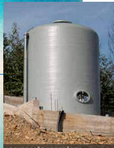
COLOCAÇÃO DE DEPÓSITO DE ÁGUA E RESPECTIVAS LIGAÇÕES EM FOZ DO RIBEIRO
