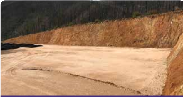
Construção de largo para parque de estacionamento junto ao cemitério de Carvalho
