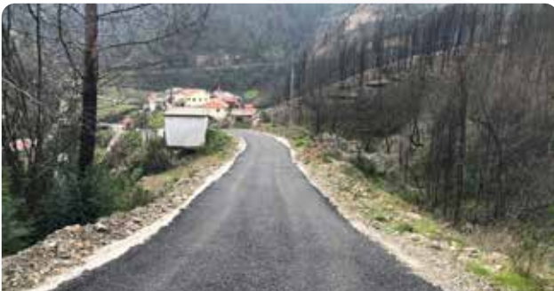
Pavimentação de arruamento de acesso ao depósito de água em Ponte de Fajão
