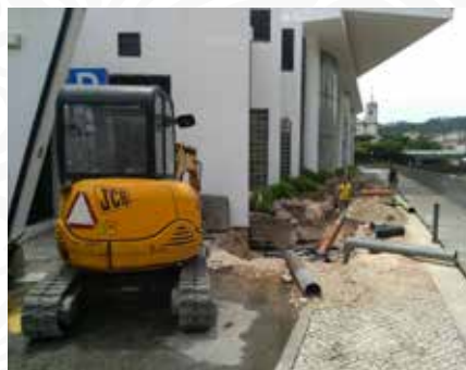
06 Reparação da conduta de saneamento, junto à praia fluvial de Pampilhosa da Serra
