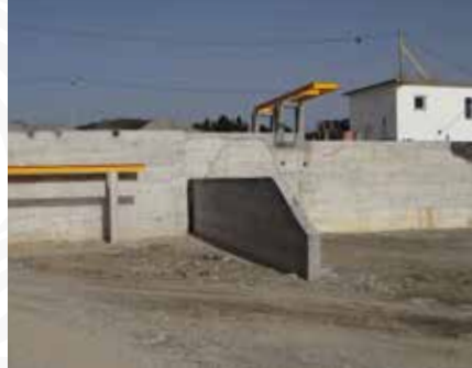
12 Construção de muro e diversas requalificações da central de alcatroamento do Município
