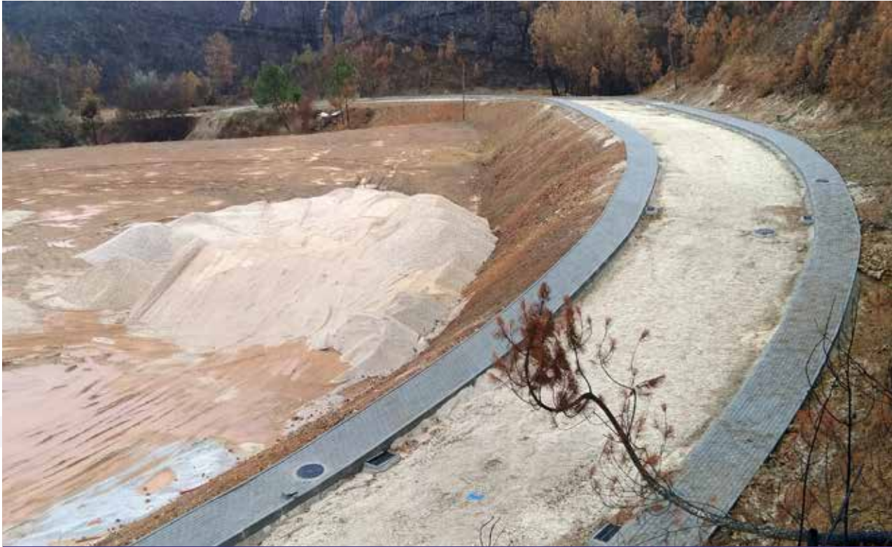
Continuação dos trabalhos da 2ª fase do alargamento da Quinta de São Martinho
